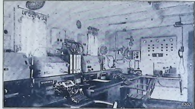
Abb. 2. Teilansicht des Funkraumes auf der „Friesenland“. Auf der linken Seite die Empfänger, deren Bedienung von jedem Arbeitsplatz aus möglich ist. In der Ecke zur Rechten der Peiler
