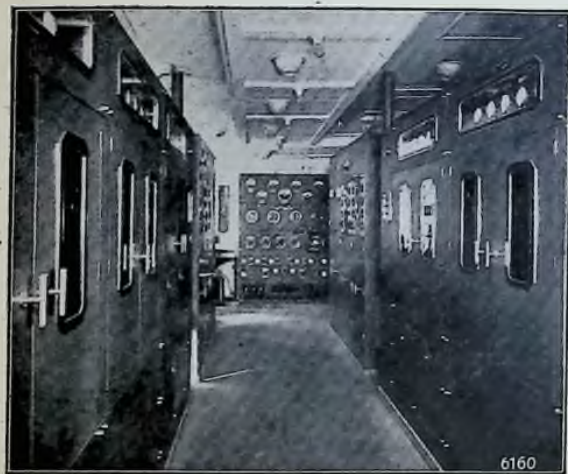
Abb. 2. Blick in den Senderraum
