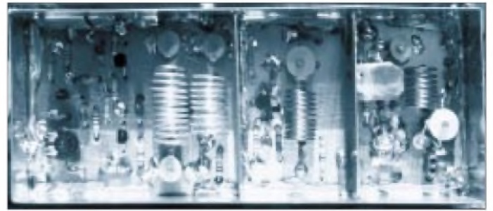
Bild 10: Ansicht der Baugruppe Sendeumsetzer
