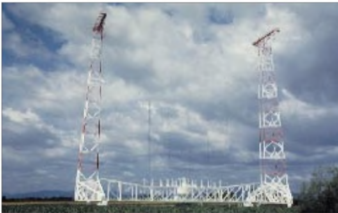
Die drehbare Vorhangantenne, geeignet für 500 kW Sendeleistung
