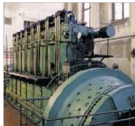
1000-PS-Dieselmotor im Maschinenraum des Senderhauses 1
