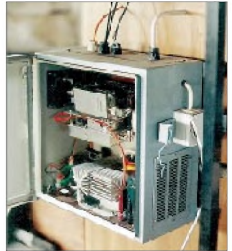
Versorgungsschrank bei DB0FDD (u.a. Netzteil)
