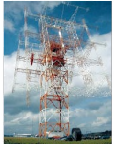
Drehstandantenne des KWZ 1
