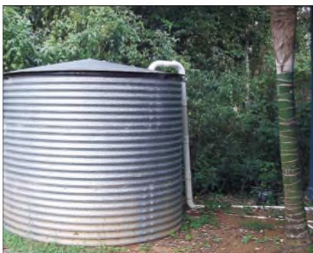
Der Wassertank als Betriebserde
