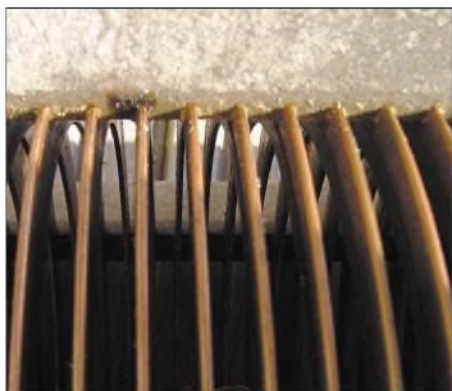
Bild 3: Infolge Feuchtigkeitsaufnahme stark angegriffene Isolierstege
