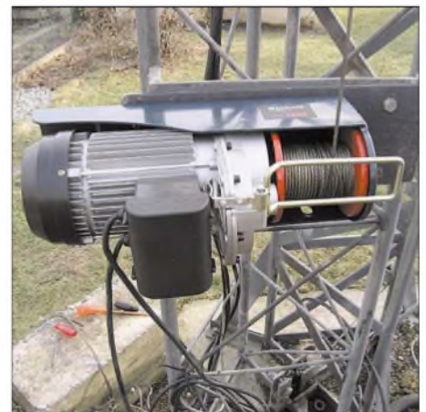
Fertig montierte Elektrowinde am Versa-Tower Fotos: DJ3QX
