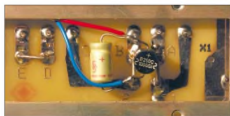
Blick in den Anschlusskasten Foto: DL2QZ
