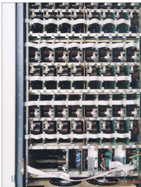
19"-Gestell mit 48 Verstärkermodule
