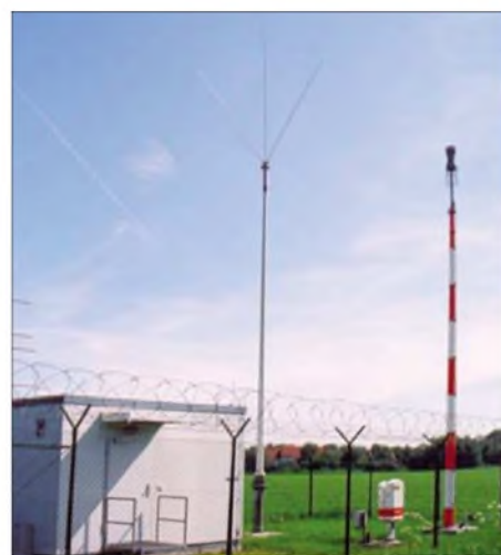
Sendecontainer und Antennenanlage der NDB ERT
