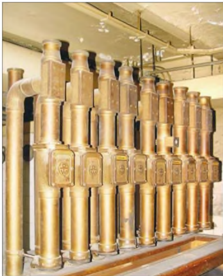
Bild 5: Hausrohrpostanlage (Empfangsstation) des Haupttelegrafenamtes
