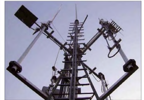
70- und 23-cm-Antennenanlage bei DB0BOS (Böllstein/Odenwald) Foto: DG9FCJ
