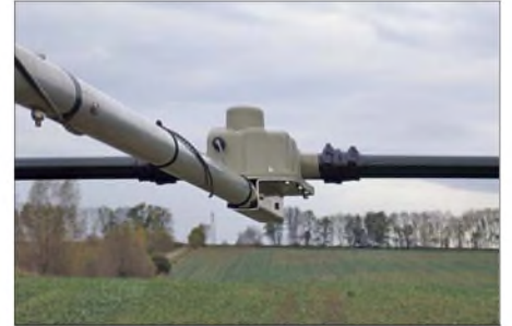
Bild 10: Steuerkabel um den Boom, ...
