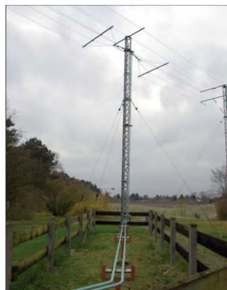
Speiseleitung und Einspeisung der Kurzwellenantenne
