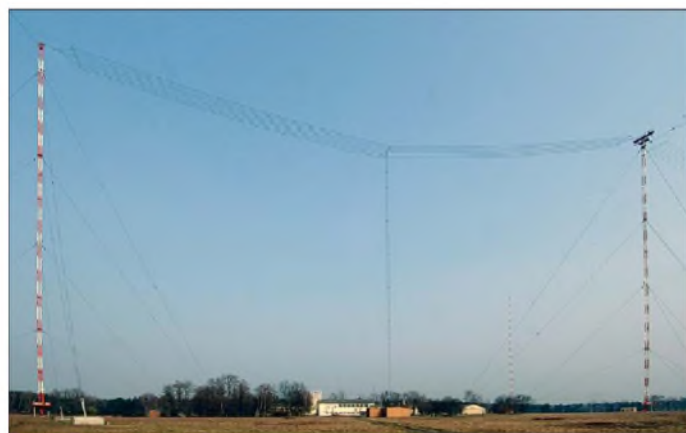
Bild 1: Blick auf die DCF77-Sende- antenne mit Dachkapazität
