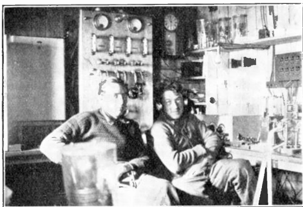
Station principale : Poste de T. S. F.
