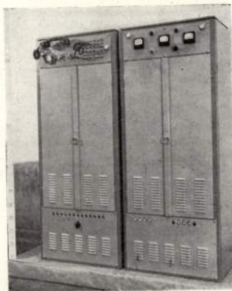
FIG. 2. — Bâti radio type MXH 620 ; bâti 12 voies impulsion type MXV 620 (portes fermées).
