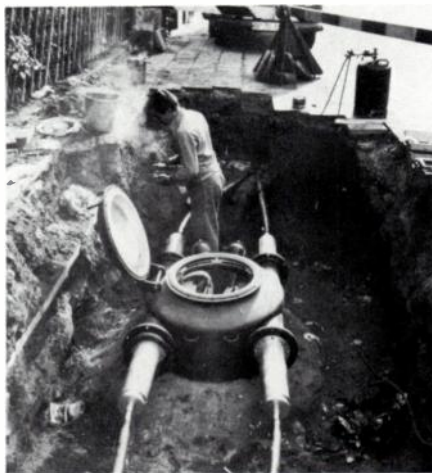
Nouveau réseau de transmission numérique de données équipé du système PCM 300 des régénérateurs sont prévus à des intervalles de 9 km.
