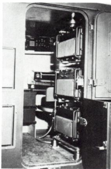
Fig. 6. — Centre Automatique de Réception et d'Émission de Messages (cliché SEFT).
