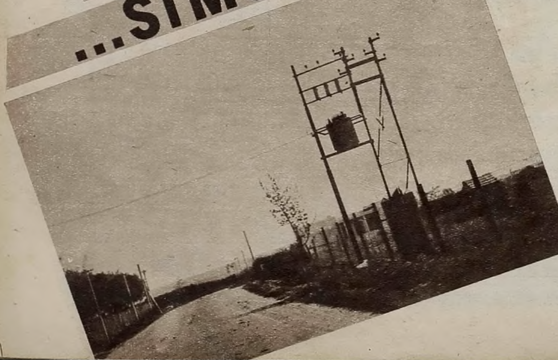
Toma de la energía eléctrica en el transformador.
